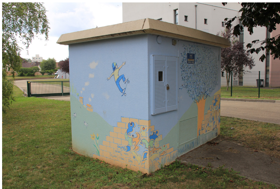
Le poste EDF de la Cité Scolaire
